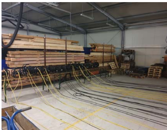
Die Kabeltrommeln sind für die Prüfung vorbereitet
